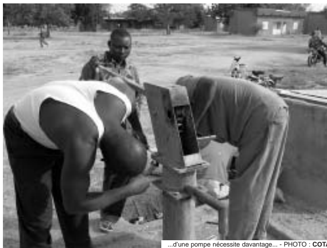
...d’une pompe nécessite davantage... - PHOTO : COTA
